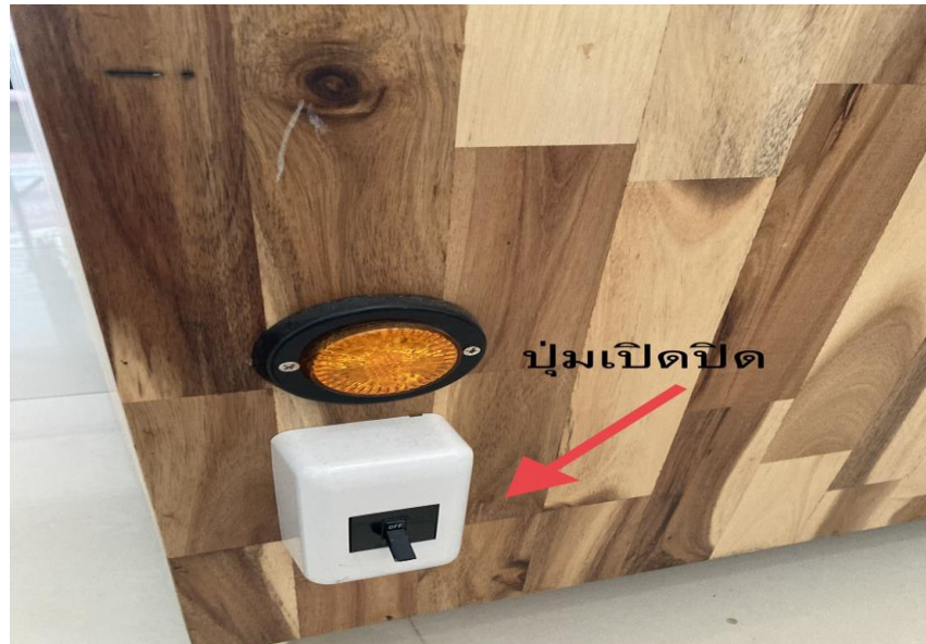
ปุ่มหลังตู้เครื่องขายคุปอง
